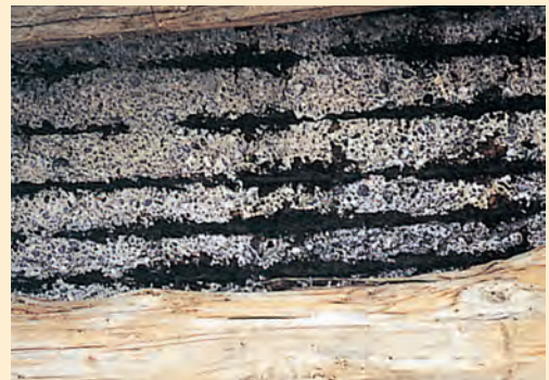
塩害による劣化例 (橋梁)
