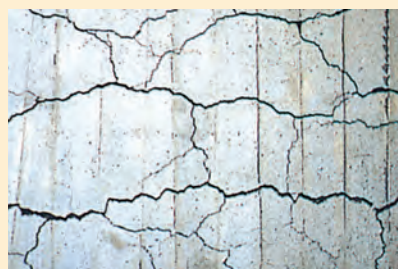
アルカリ骨材反応による劣化例 (梁)
