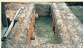
温泉水による劣化例 (源泉樹)
