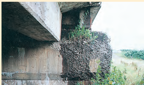
凍害による劣化例 (橋梁)
