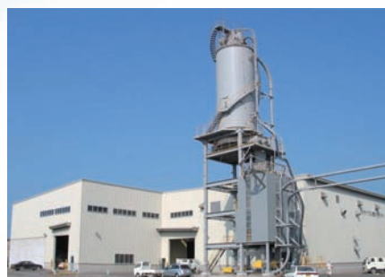
●廃プラ処理設備
