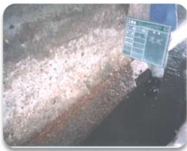
施工前 (劣化状況)
